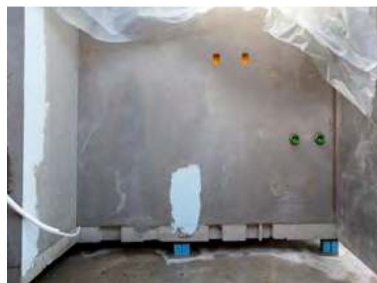
I højre side af badeværelset er væggene til tekøkkenet allerede klar - inkl. rørføring til vand og elinstallationer.
